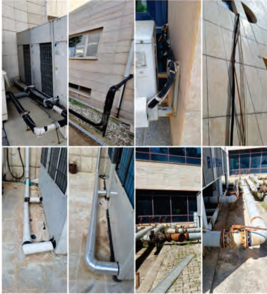
Şekil 9: Soğutma Sistemleri Tesisatları
