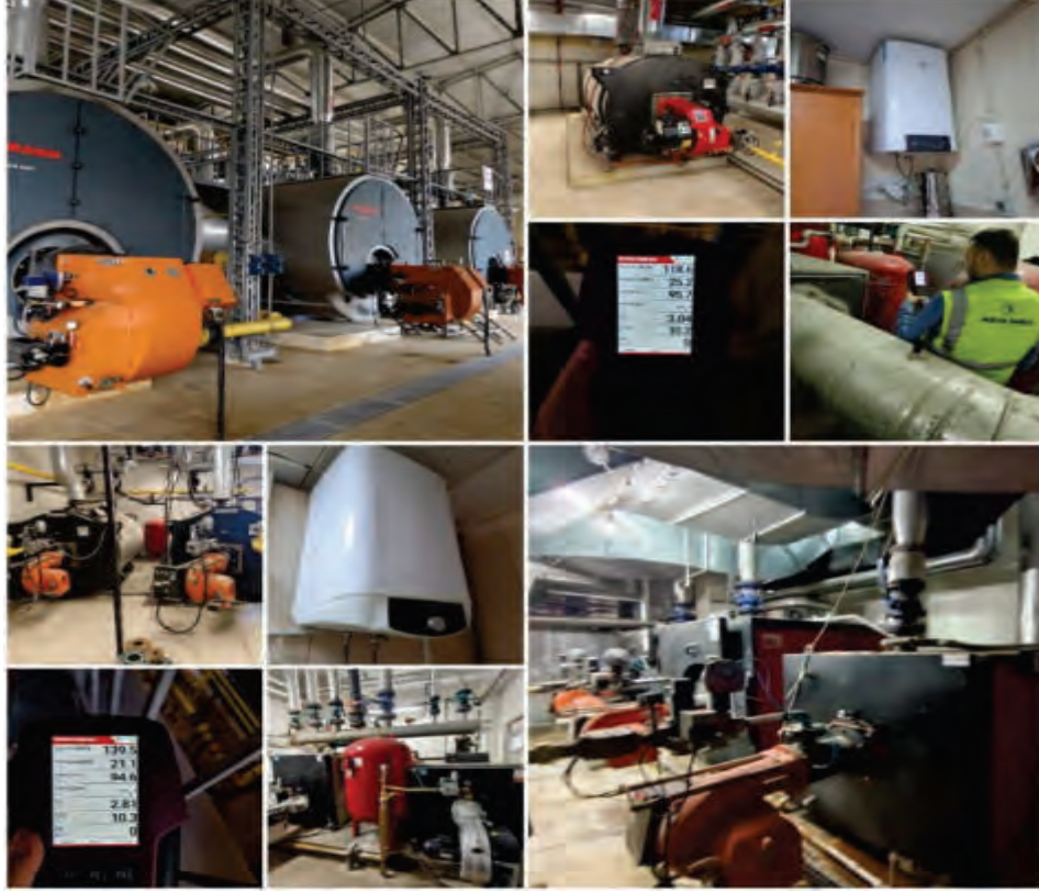
Şekil 7: Isı Merkezi-Sıcak Su Kazanları
