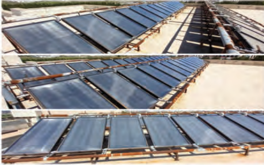
Şekil 31: Güneş Kolektörü Panelleri
