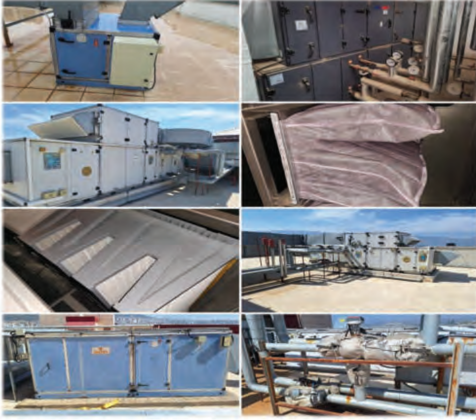
Şekil 10: Havalandırma Santrali Görüntüleri
